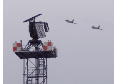
Abb. 17: die Stacked Beam Cosecans 2 - Antenne des Flugsicherungsradargerätes ASR-910
